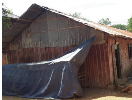
Das alte Schulgebäude aus Holz mit Zinkdach verrottet zunehmend und droht einzustürzen
