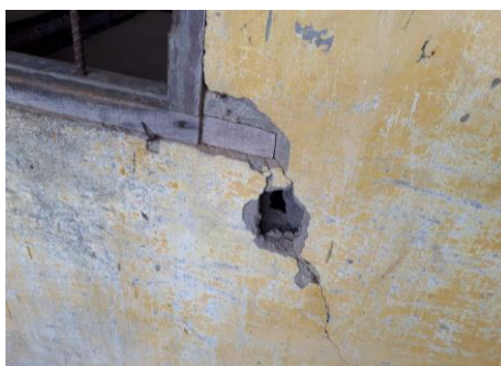
Viele Risse und Löcher in den Wänden und im Dach machen das Gebäude instabil und es droht zu kollabieren.
