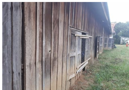
HolzWände sind morsch und voller Löcher, die Fenster provisorisch vergittert
