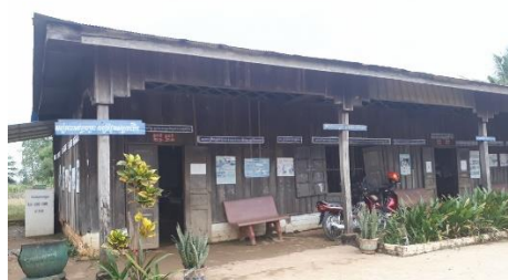
Das baufällige Holzgebäude mit drei Klassenzimmern
