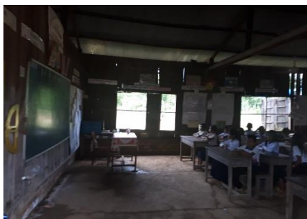
Ein düsteres, verrottetes Schulzimmer mit rissigem Boden und Löchern im Dach
