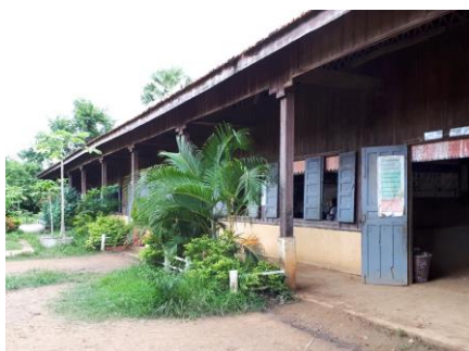
Das auffällige Holzgebäude der Wat Chaeng Primarschule droht einzustürzen.
