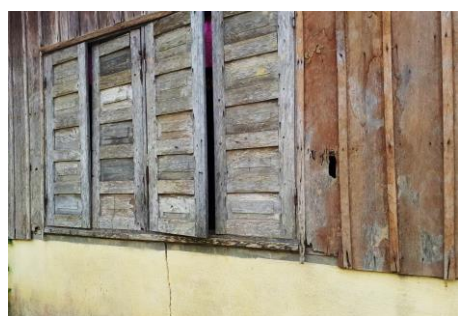
Die Holzwände sind morsch, voller Löcher und bieten keinen ausreichenden Schutz vor Unwettern.
