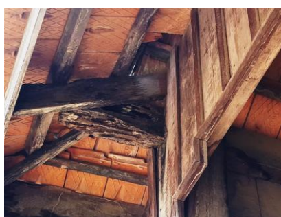
Feuchtigkeit und Ungeziefer haben zahlreiche Holzträger schwer beschädigt.
